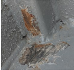
Рисунок 1 – Зона дослідження корозії в металевій конструкції
